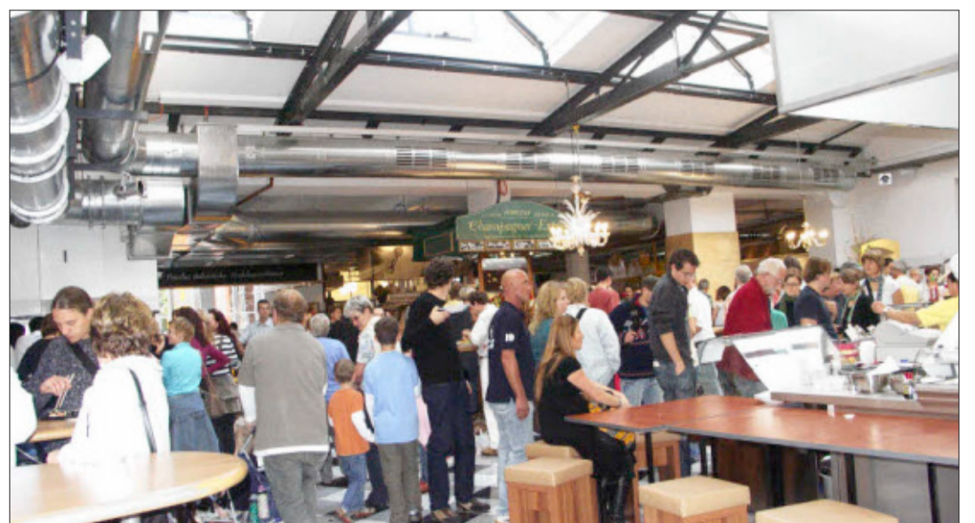
Dicke Rohre sorgen für frische Luft – gegebenenfalls auch für abgekühlte.
